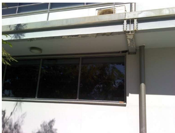
Εικόνα 6: Αποκόλληση μπογιάς από μεταλλικό σκελετό, νότια του κτηρίου
