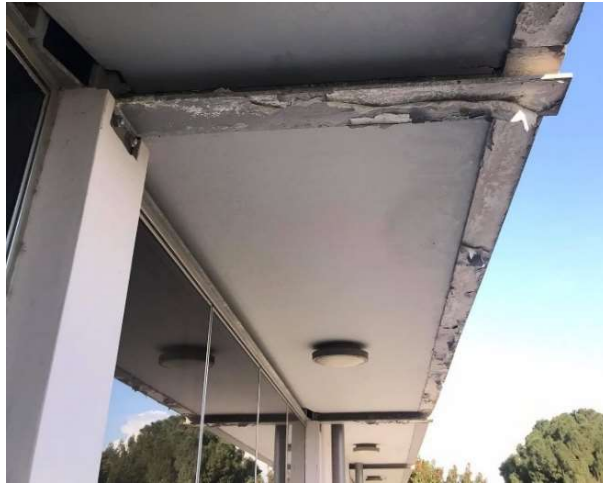
Εικόνα 3: Αποκόλληση μπογιάς από μεταλλικό σκελετό, νότια του κτηρίου
